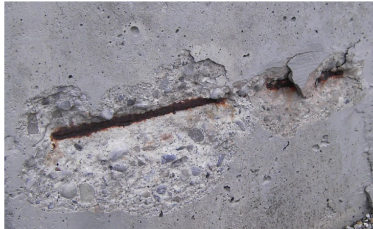
Abbildung 46: Abplatzung durch Karbonatisierung
