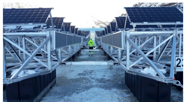
Bild 68: Solarfloating-Anlage auf dem Grund des Sees. (Unterkonstruktion von K2)
