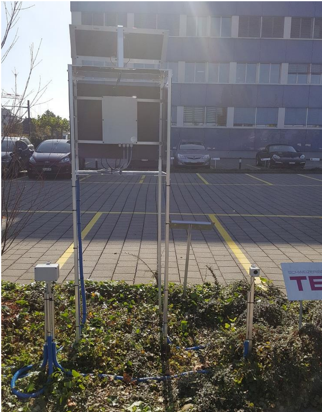
Abbildung 101: Elektronikbox und Solarpanel bei der TEKO Zürich
