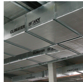
7 Lüftung Sichtbare Lüftungskanäle an Decke, silbergrau
