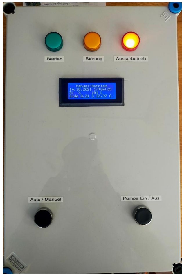
Abbildung 25: In Betrieb gesetzte Steuerung
