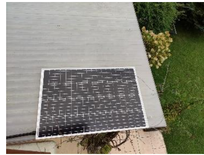
Abbildung 19: Montiertes Solarpanel auf Pergola
