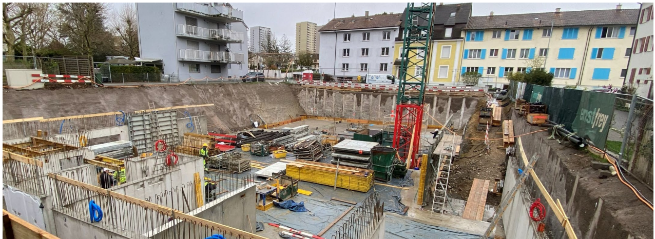
Abbildung 56: Unordnung auf der Baustelle
