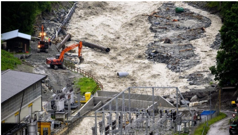
Abbildung 21 Hochwasserschäden in Graubünden
