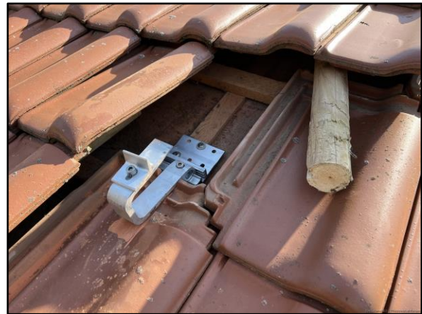
Abbildung 10: Dachhaken PV-Anlage (google.com)
