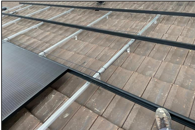
Abbildung 69: Montagesystem mit Single-Rail-Schienen (Foto von Smartphone)
