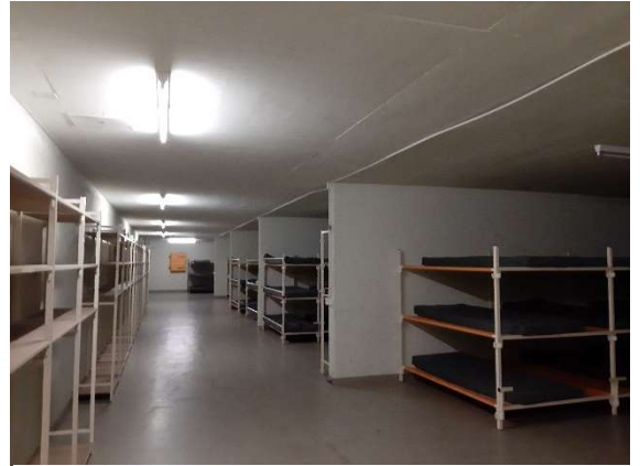
6-8 Beleuchtung Öffentlicher Schutzraum
