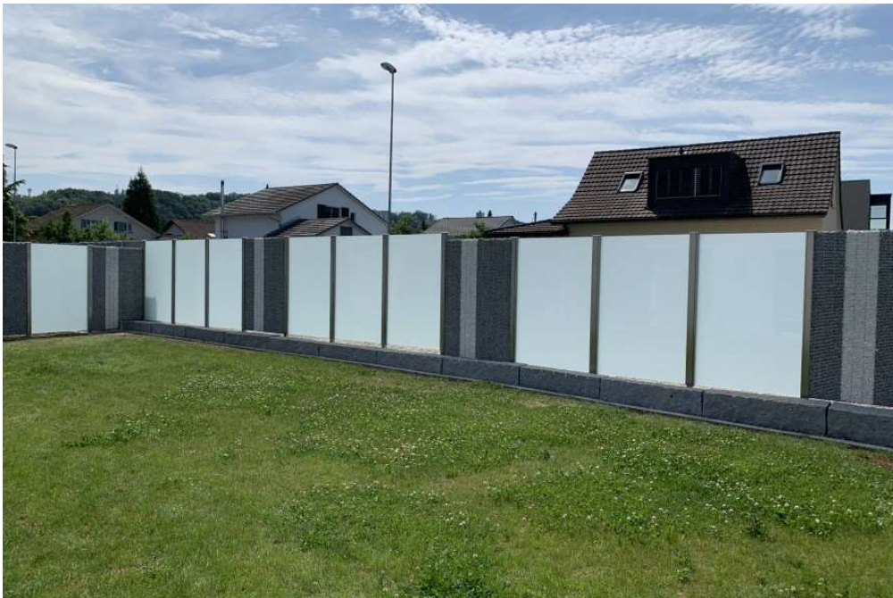
Abbildung 21: Beispielbild von Glas Lärmschutzwand (Sabatella, 2023)
