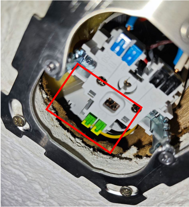
Abbildung 39 Eingebauter Sonoff Switch mit Änderung zu einfachem Stecker
