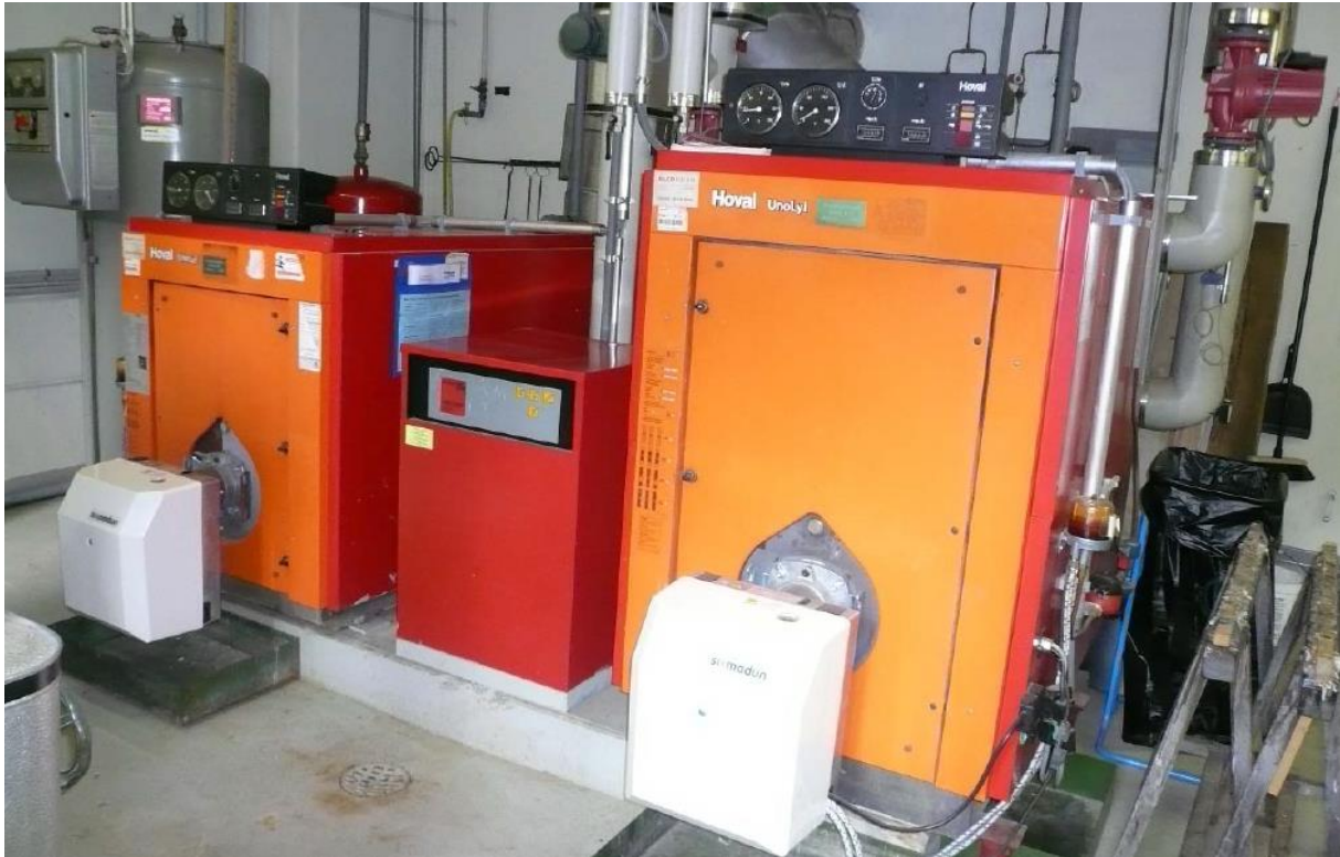
Bild 2: Die beiden Ölkessel Hoval im Türmlischulhaus aus dem Jahr 1991 mit einer Leistung von 128 und 152 kW.
