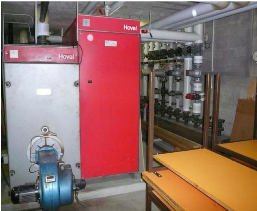
Bild 1: Blick in die Heizzentrale der Turnhalle mit dem Ölkessel aus dem Jahr 1976.
