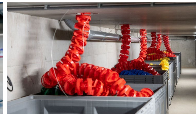
Abbildung 44: Behälter unter Schwimmbad
