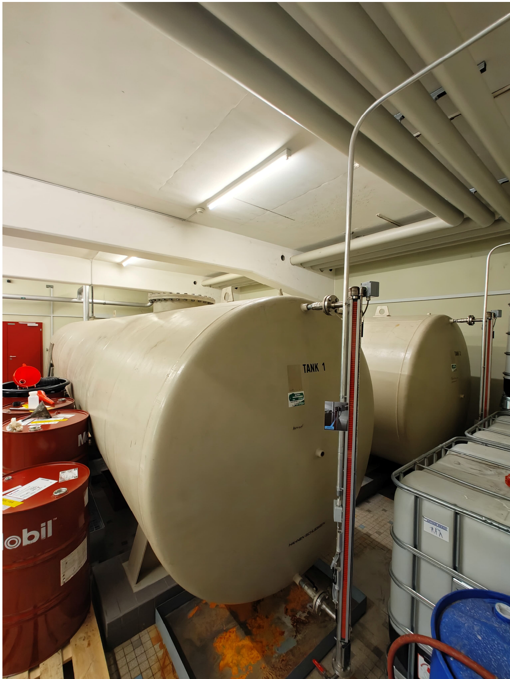
Abbildung 14: Bestehende zwei Kühlwassertanks mit Füllstandsüberwachung
