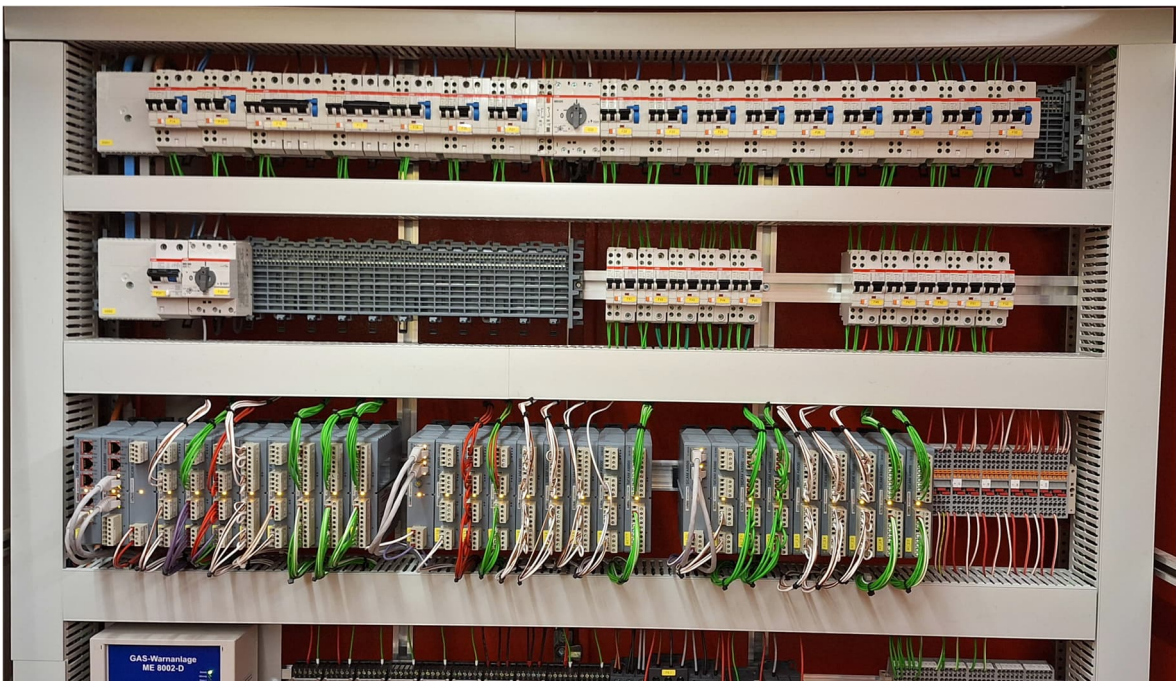
Abbildung 8: SICAM A8000 im Schaltschrank, unterhalb der Sicherungen
