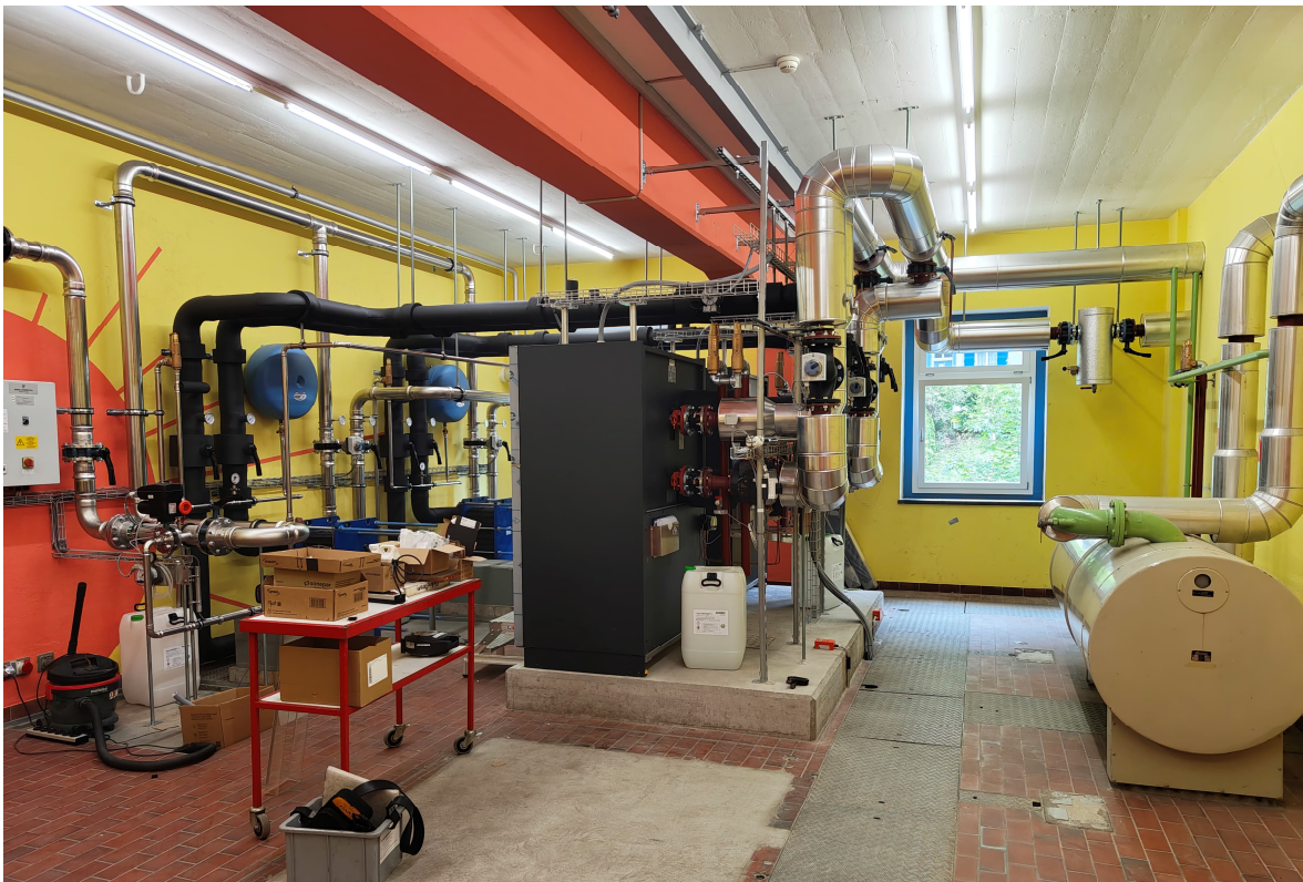
Abbildung 1: Heizraum nach abgeschlossenem Umbau, 05.09.2025
