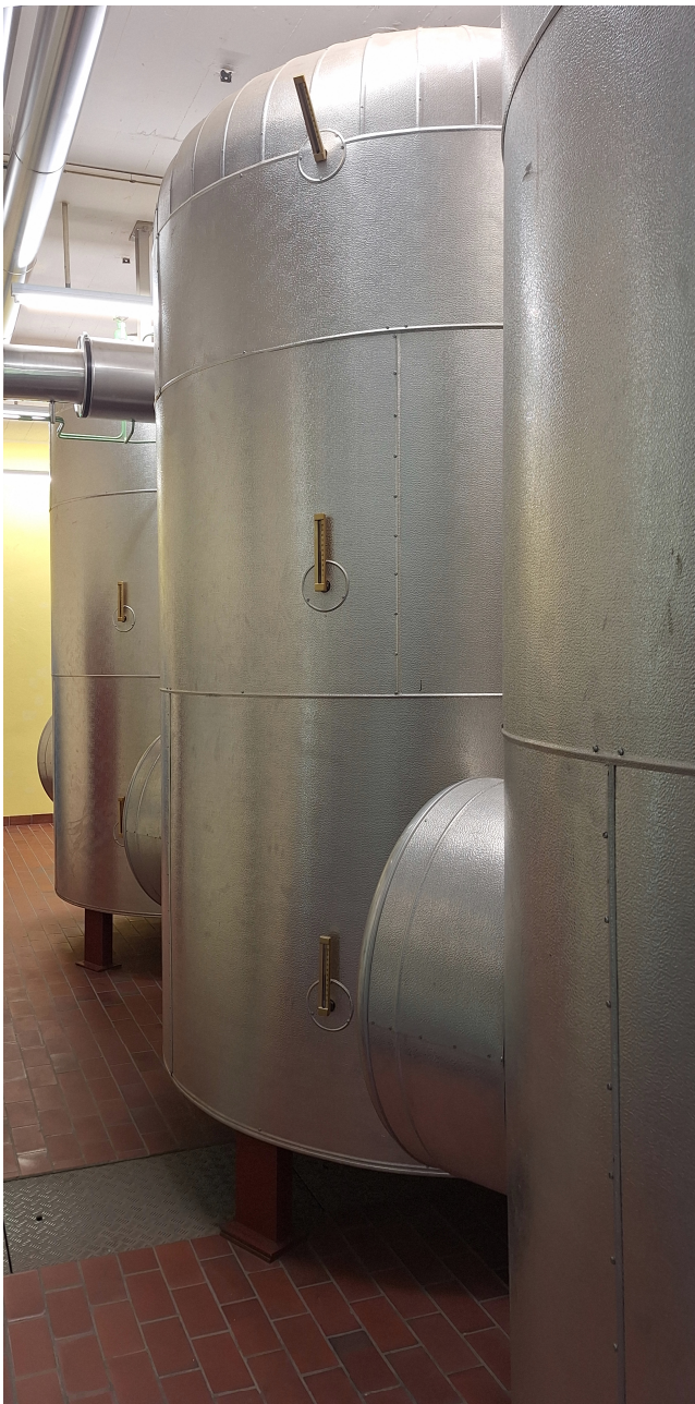
Abbildung 13: Drei bestehende Wärmespeicher, 6000 L je Speicher
