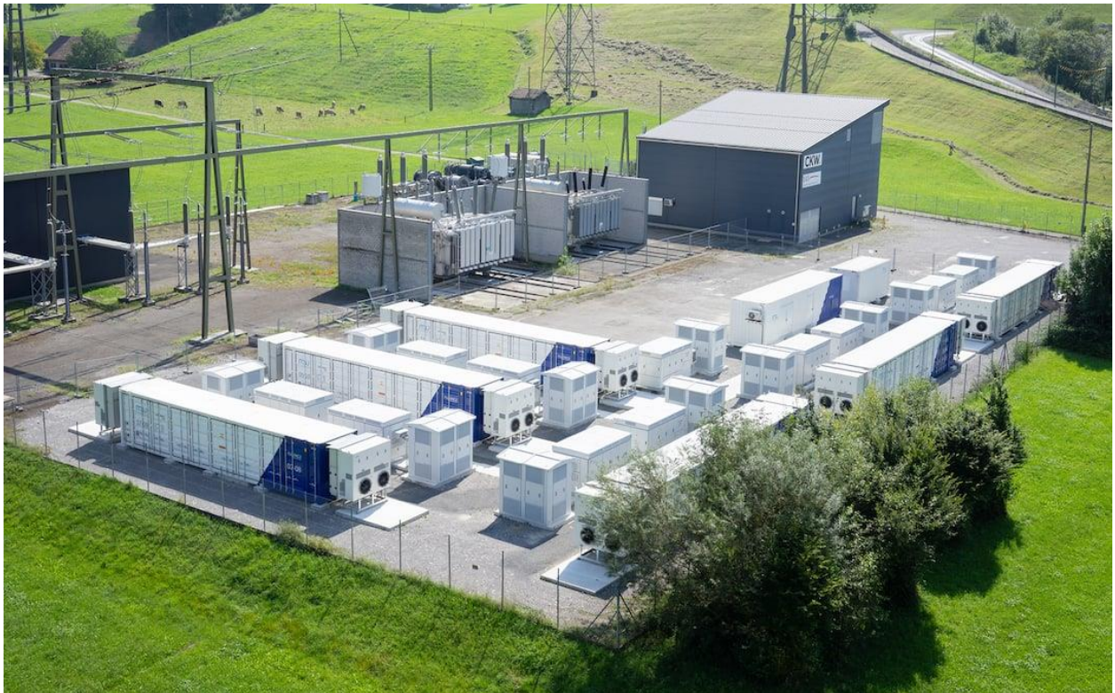
Abbildung 32 In Betrieb genommene Anlage in Ingenbohl
