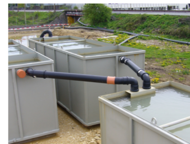
1) Absetzbecken / Neutralisationsanlage der-werkhof.com
