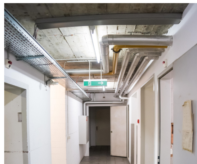
Leitungsführungen an Decke UG
