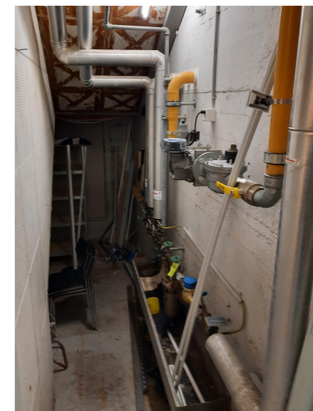
Sanitärverteilung unter Treppe
