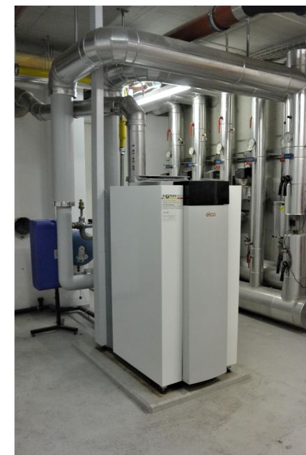
Heizzentrale (Gas) von 2016
