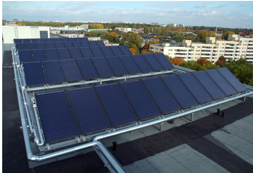
Solarthermieanlage auf einem Flachdach
