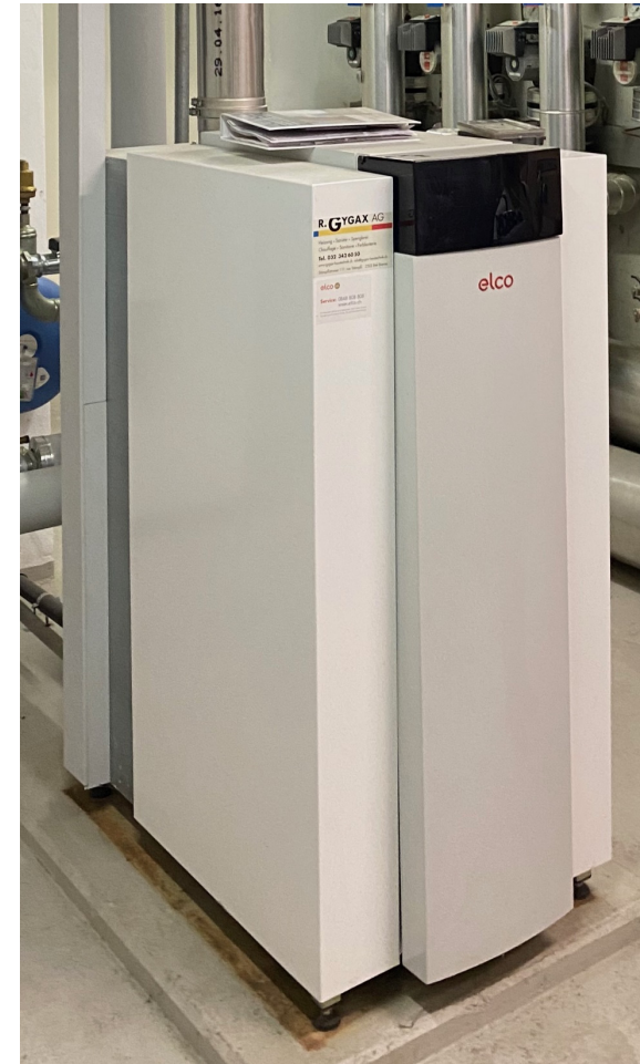
Bestehende Gasheizung mit 137kW
