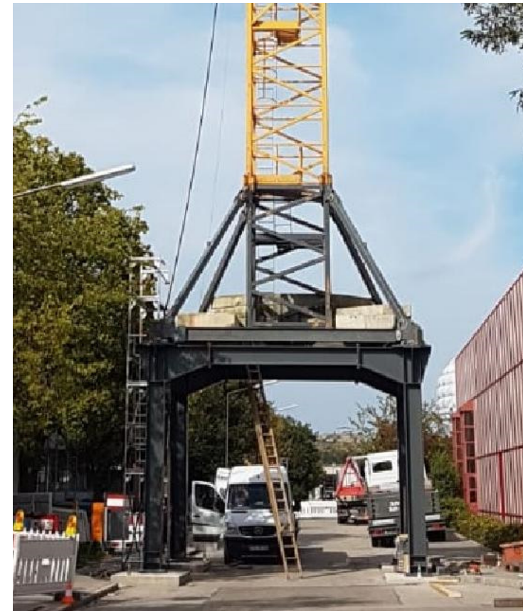
Portal für Baukran
