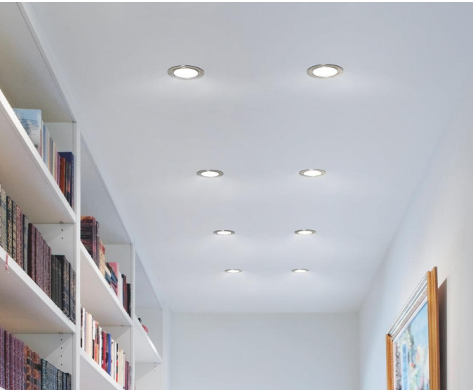
Spots in Korridor unterputz
