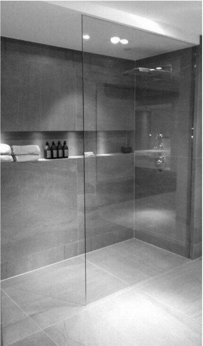
Boden- und Wandplatten Nasszellen / Duschtrennwände
