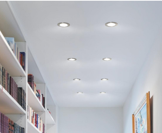
Spots in Korridor unterputz
