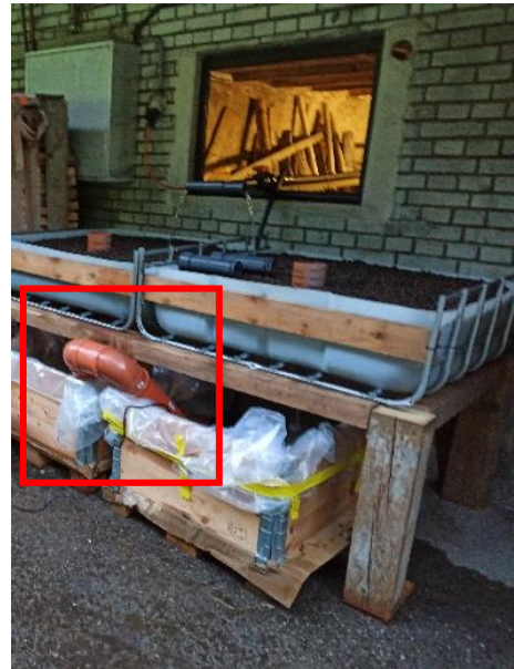
Abbildung 64 Kommunizierendes Rohr installiert zwischen den Sumpftanks [24]
