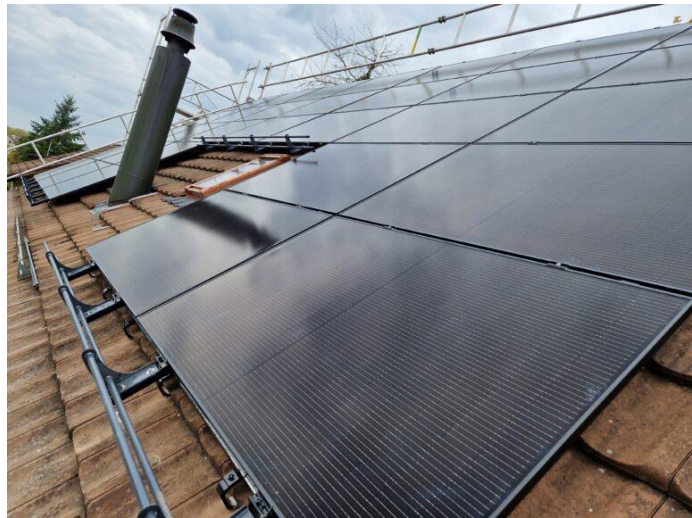
Abbildung 16: Schneefang an Unterkonstruktion (solarsys.ch)
