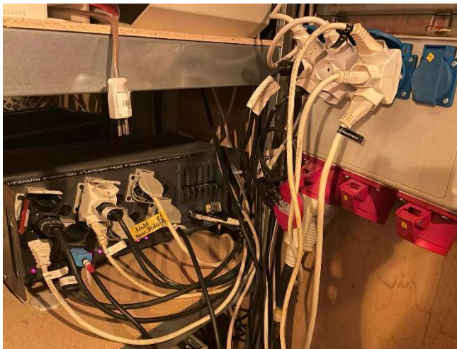
ABBILDUNG 12: KABELSALAT, EIGENE AUFNAHME
