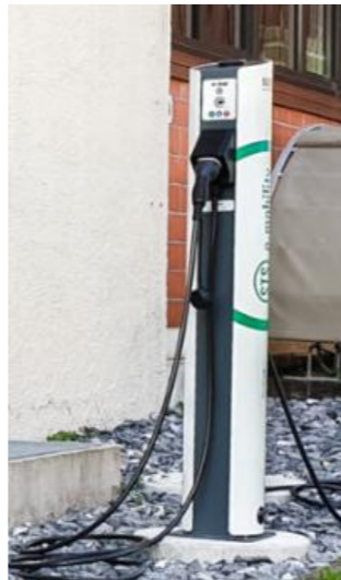
Bei E-Auto PP Elektroladesäule ähnlich STS
