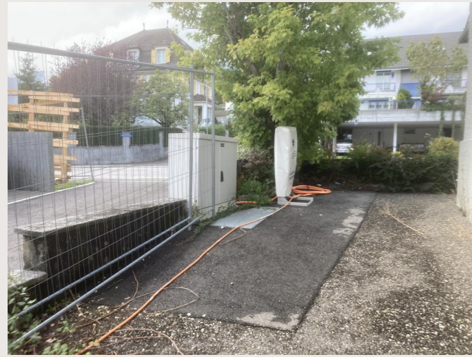
Situation vor Ort: EL-Kasten (Baustrom anschliessen)
