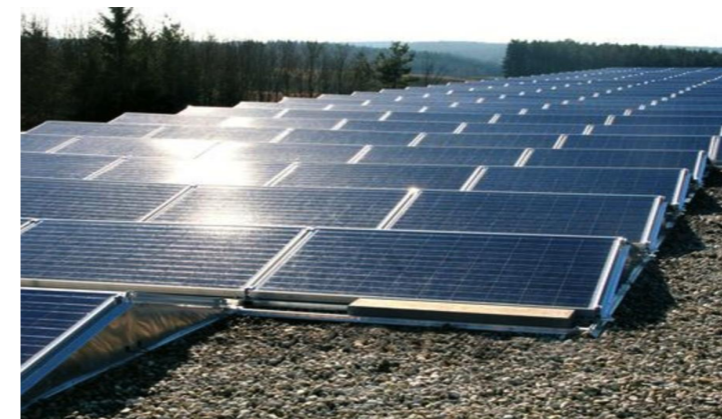
PV-Anlage mit Kies auf Dach
