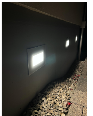
4 Wandeinbauleuchte in Beton eingelassen
