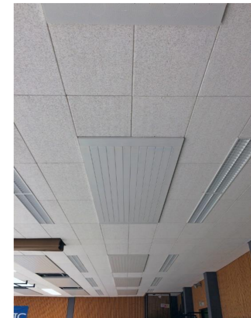
Deckenstrahlplatten kombiniert mit heruntergehängter Decke
