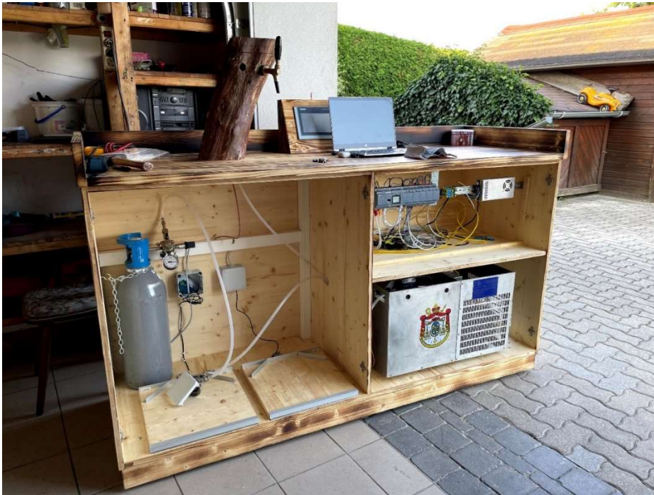
Abbildung 30 Anlage ohne Abdeckungen
