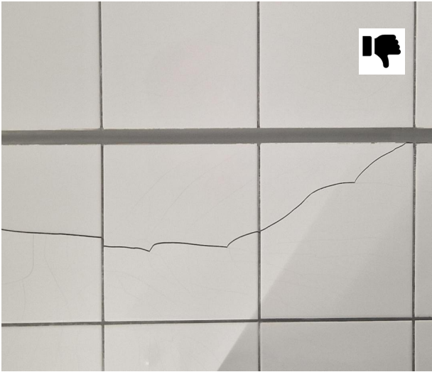
07) Riss in Plattenbelag
