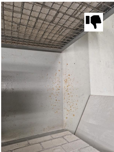
11) Rostspuren der Gittertür
