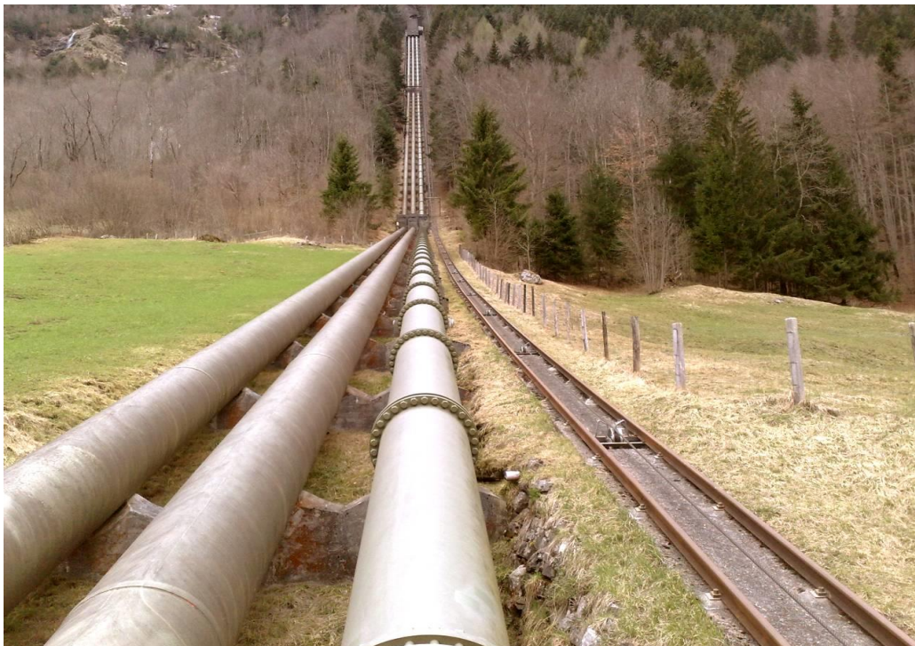
Abbildung 18 Druckleitungen und Überlaufleitung Wasserkraftwerk Kandergrund; Quelle: https://standseilbahnen.ch/images/3000/3716.01-kandergrund-kraftwerk-2.jpg
