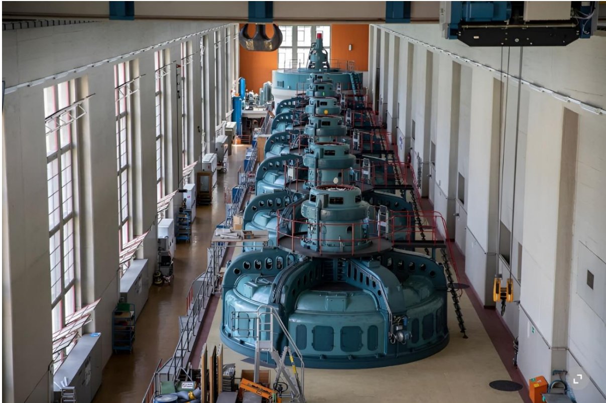
Abbildung 12 Turbinenhalle Wasserkraftwerk Mühleberg; Quelle: https://www.bernerzeitung.ch/seit-100-jahren-die-gleichen-turbinen-995911458061
