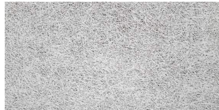
Zementgebundene Holzfaserverplatte - Deckenuntersicht Parkdeck
