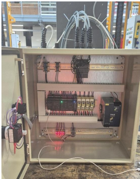
Abbildung 3-13 Schaltschrank in Betrieb
