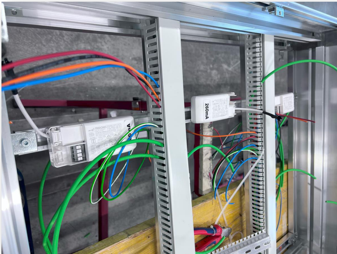
Abbildung 6 Die befestigten LED-Betriebsgeräte an der zusätzlichen Schiene
