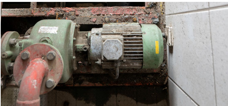
Abbildung 6: Handwaschpumpe auf der linken Seite
