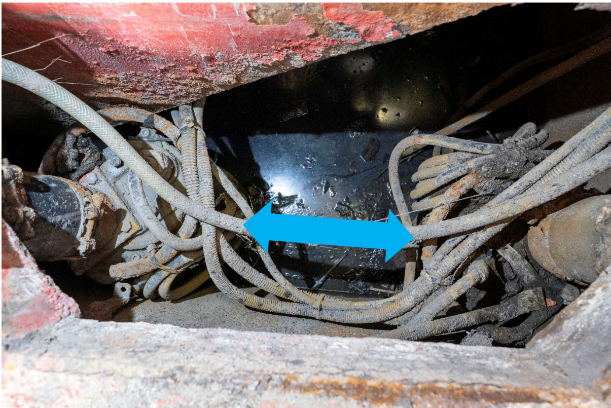
Abbildung 4: Tauchpumpen versenkt auf der rechten Seite
