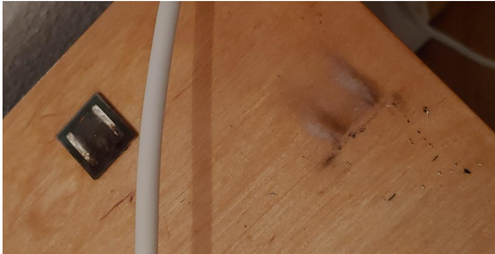
Abbildung 7: Abbrandspuren eines ungekühlten 600W-Leistungswiderstandes
