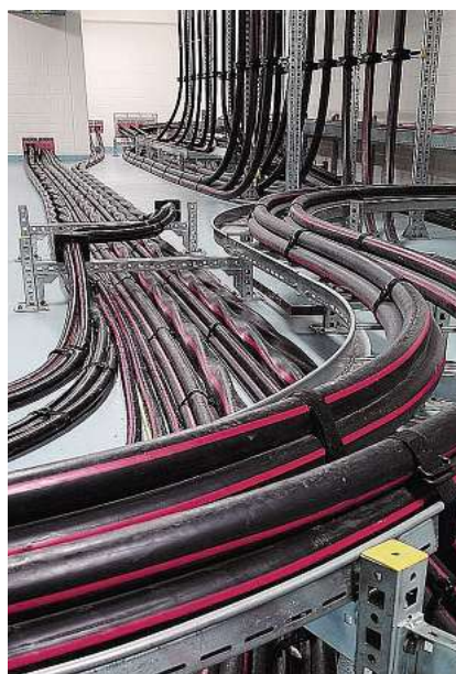
Verkabelungen in Gebäuden und Anlagen
